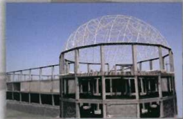
مرکز تجاری گلستان - شهرک مکانشهر - اردبیل تقویت سازه بتنی به روش Steel Jacketing و FRP به دلیل تغییر سیستم سقف
