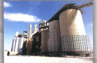
کارخانه سیمان آباد - تقویت سیلوهای بتنی و سازه های صنعتی با FRP برای افزایش عمر مفید سازه ها
