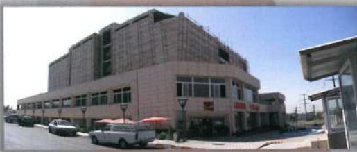
مجتمع تجاری الماس - تهران - چهارراه مینی سیتی بهسازی لوزه ای و تقویت سازه بتنی با FRP
