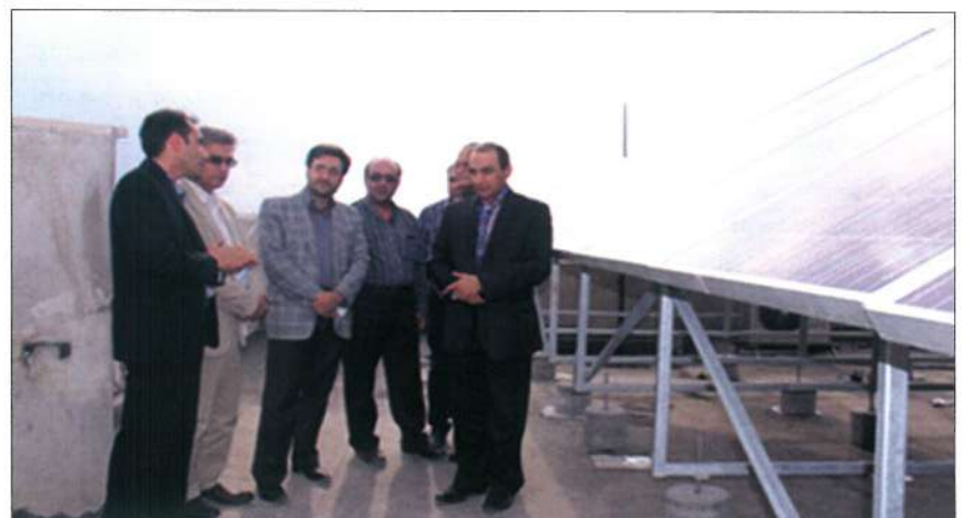
تجهیزات پنل‌های فتوولتائیک نصب شده بر روی ساختمان موجود نظام مهندسی اصفهان - ۱۳۹۳
